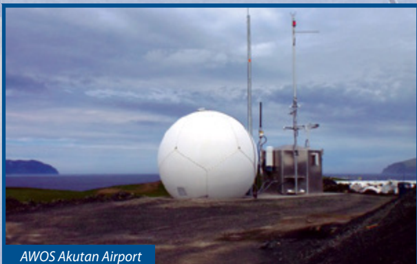
AWOS Akutan Airport
